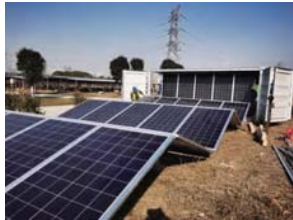
④ Unfold Solar PV Array
